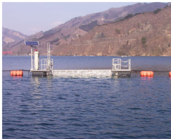
自動通船ゲート（ソーラー・電動スライド式）
