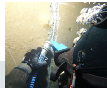
クラック補修
